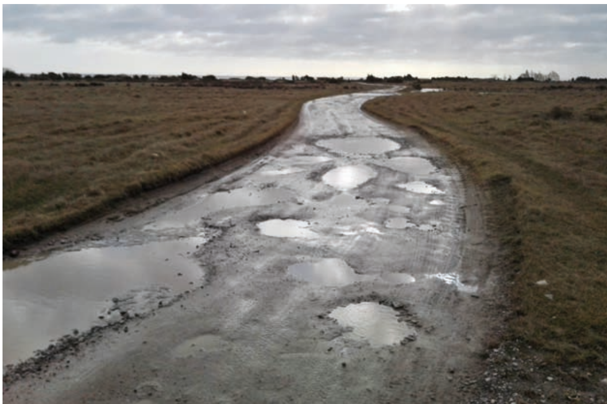
Figur 19. Vägen ned till Sandby borg innan förbättringsåtgärderna 2017.
